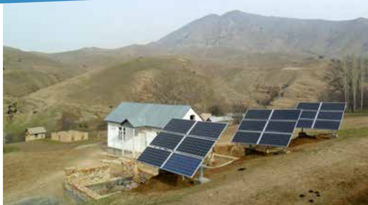
Фотоэлектрическая станция (мощность 3 кВт), установленная ЮНИДО на фельдшерско-акушерском пункте (ФАП) в селе Таштак Аксынского района Джалалабатской области в марте 2013 г. ФАП обслуживает 1080 человек.
